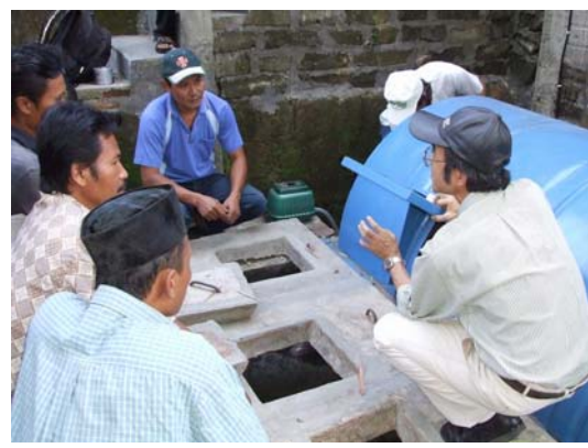
コミュニティ排水処理設備の運転管理研修
